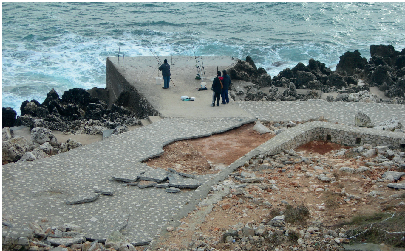
Figura 6 – La determinazione su base geomorfologica della fascia raggiunta dall’onda montante durante le mareggiate avrebbe potuto evitare i notevoli danni prodotti dall’evento del dicembre 2008 lungo la costa tra Castro e Marina di Andrano.
