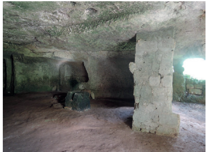
Figura 8 - Angolo Sud-Est dell'ambiente n. 3: pilastro in blocchi calcarenitici con evidenti fratture lungo tutta l'altezza e innesto di muro divisorio alla base; sullo sfondo frattura di tipo (a) presente al contatto fra la parete verticale e il tetto dell'ipogeo.
