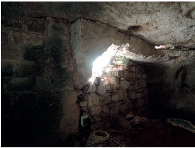
Figura 6 - Angolo Sud-Est dell'ambiente n. 3: frattura di tipo (a) presente all'intersezione fra la parete verticale e il tetto dell'ipogeo.
