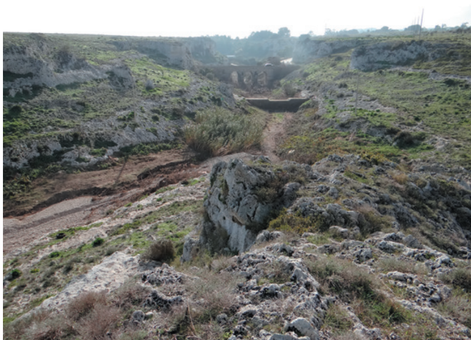
Figura 32 - La briglia ed il ponte della SP 87 visti da nord un mese dopo l'evento.
