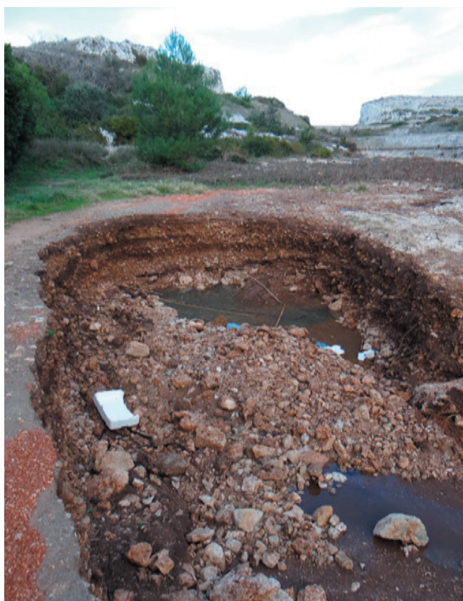
Figura 35 - La nicchia erosiva formatasi in corrispondenza dell'area di emergenza delle acque di infiltrazione. E' ben visibile il deposito clastico eterometrico stratificato di colore marrone che costituisce il riempimento del solco relitto.
