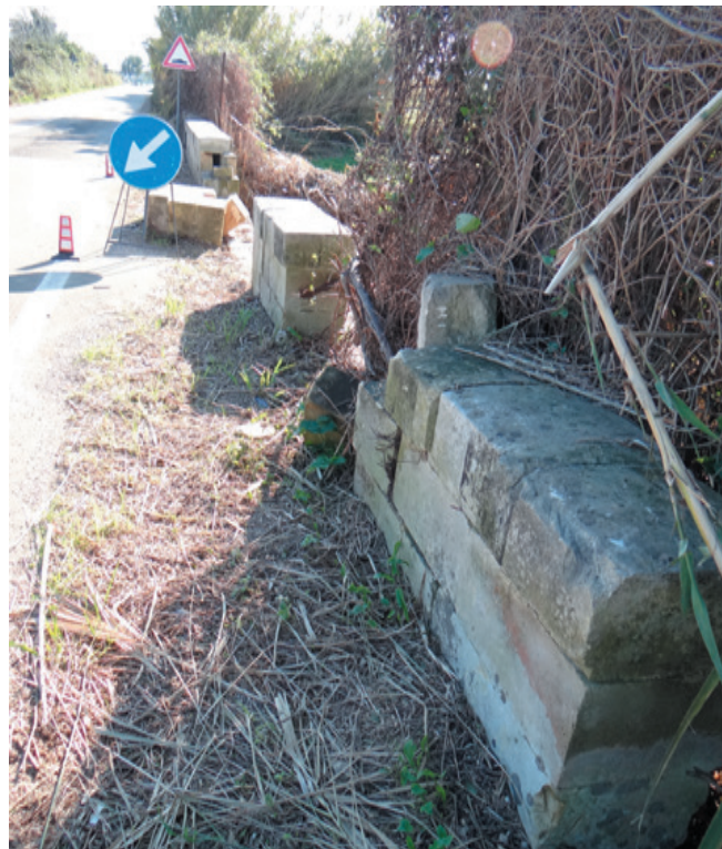
Figura 30 - I danni prodotti dall'erosione del canale di bonifica in corrispondenza della sua intersezione con la SP 358, all'altezza del depuratore di Uggiano la Chiesa.
