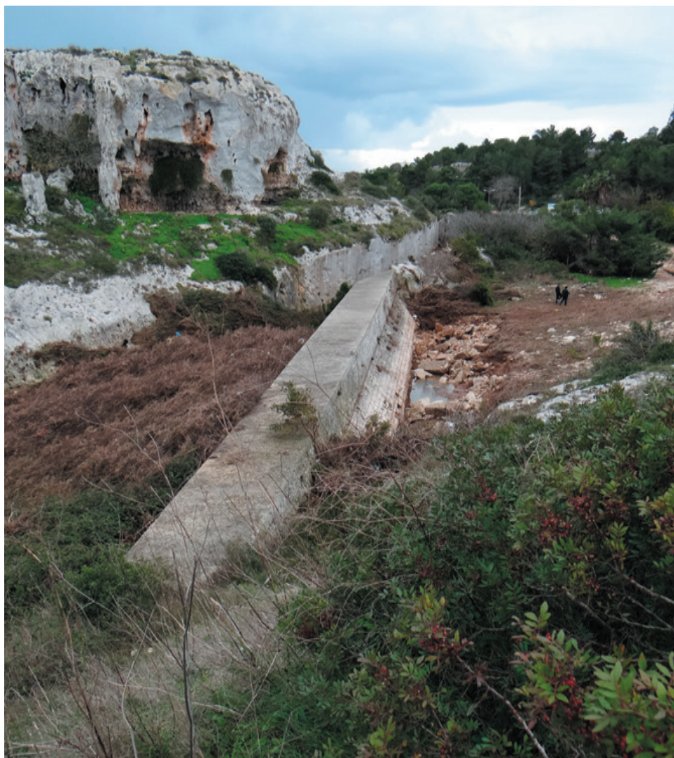
Figura 33 - Lo sbarramento della incisione di Porto Badisco mostra alla base verso valle un solco erosivo prodotto dalle acque defluite attraverso un canale di gronda presente in destra orografica.
