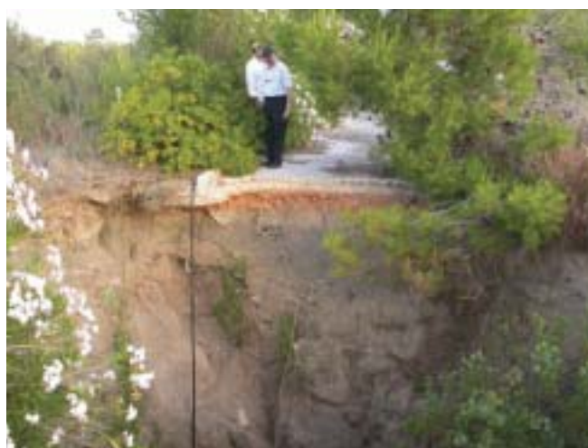
Lesina (FG), voragine nei pressi del Canale Acquarotta che ha interrotto un camminamento prossimo all'insediamento di Lesina Marina
