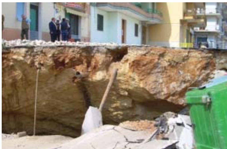
Gallipoli (LE), voragine in via Firenze. In primo piano i diversi sottoservizi che hanno sezionato la calotta della cavità antropica. Foto Fiore A., 2 aprile 2007
