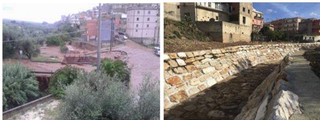
Fig. 7-8. Comune di Carpino, provincia di Foggia, interventi di manutenzione del Canale Antonino.
