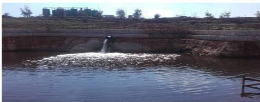
Fig. 3. Bacino disperdente dell'impianto AQP a Carovigno.
