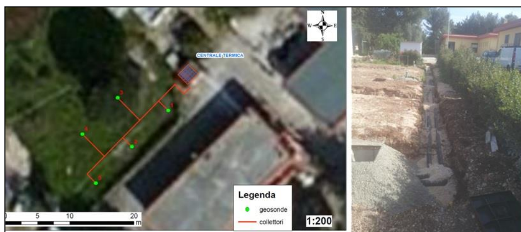
Fig. 9. Immagini relative all'impianto geotermico dell'osservatorio faunistico regionale a Bitetto.
