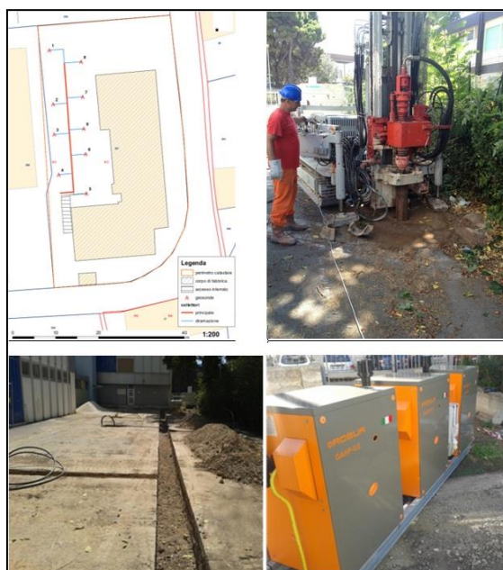
Fig. 3. Immagini relative all'impianto geotermico a servizio dell'immobile sede di Uffici regionali, in via Celso Ulpiani a Bari.
