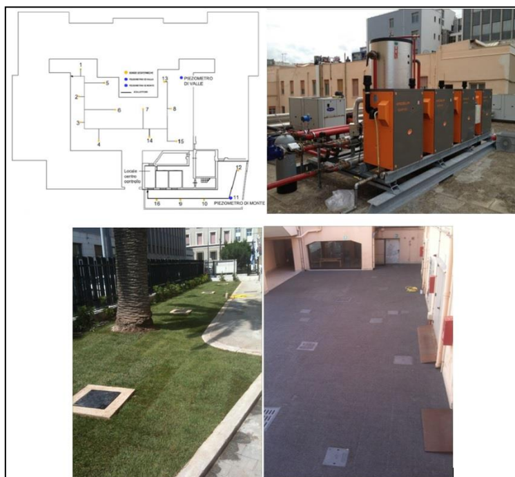
Fig. 2. Immagini relative all'impianto geotermico del "Palazzo Agricoltura" a Bari.
