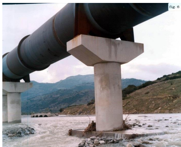
Fig. 8. Fondovalle del fiume Sinni con l'acquedotto omonimo.
