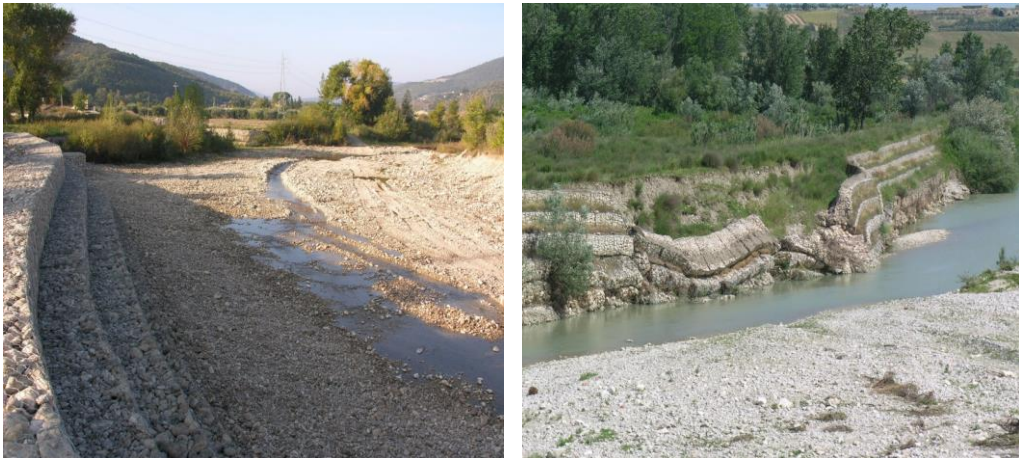
Fig. 7. Esempi di arginatura lungo il fiume Cervaro (Foggia) che rivelano, da un lato, la completa artificializzazione dell’alveo e, dall’altro, l’elevata vulnerabilità di queste strutture che, in caso di portata di piena, subiscono l’impatto delle acque e tendono a crollare, producendo ostacolo al libero fluire delle acque.
