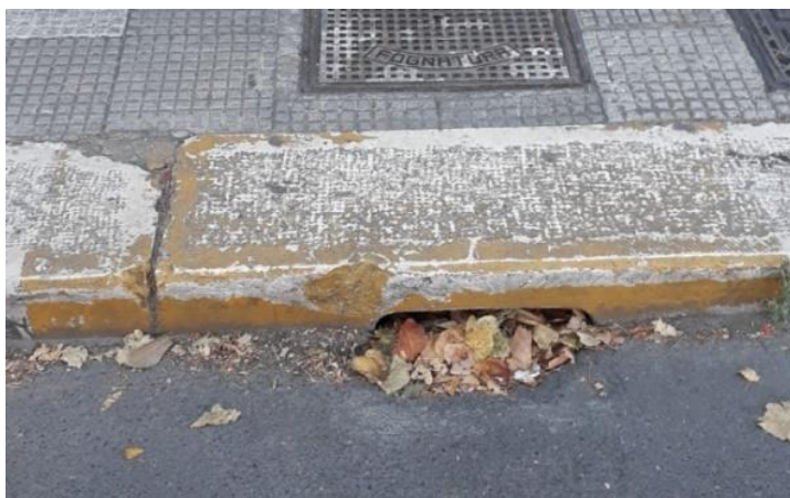
Fig. 7. Le caditoie stradali ostruite sono causa di allagamenti.
