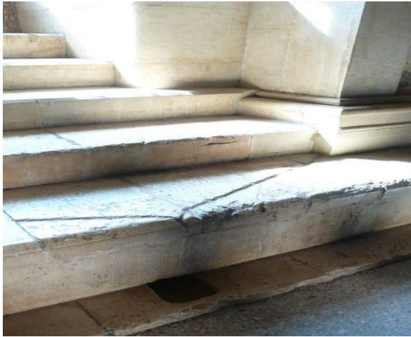
Fig. 2. Castel del Monte (Bat). Canalizzazione di raccolta e convogliamento in cisterna sotterranea delle acque di condensa sulle pareti del salone centrale.
